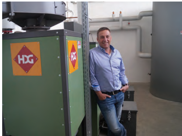
Le Forst Competence Center de la société Unterreiner dans le livre de Basse-Bavière est chauffé par un HDG Compact 150.
