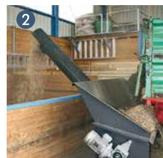
Ob mittels Frontlader (1) oder HDG Einbringschnecke (2) – die Befüllung des Lagerraumes erfolgt schnell und einfach.
