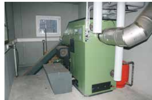
Fortführen des Heizbetriebs.
